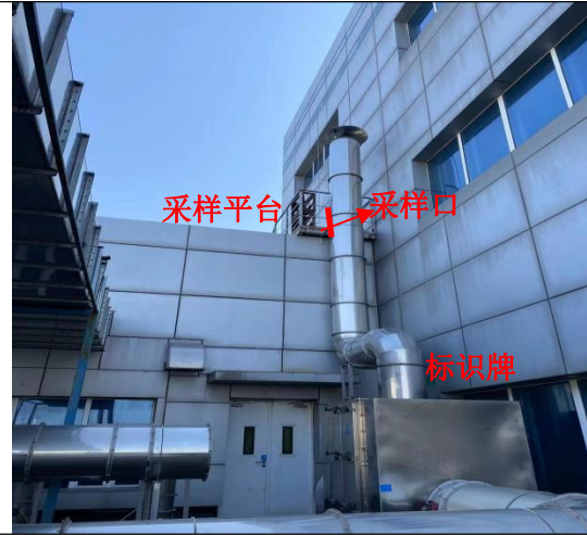
DA004 排气筒规范化
