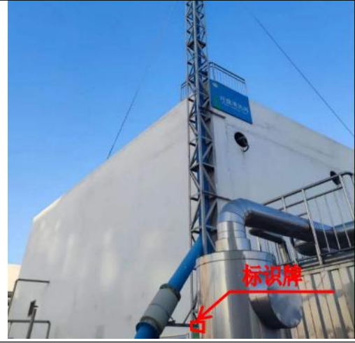
DA002 排气筒规范化
