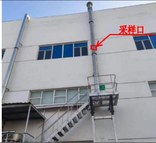
DA001 排气筒规范化
