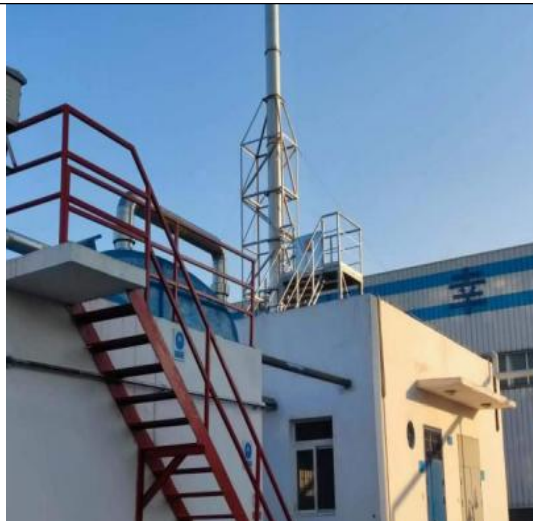
DA005 排气筒规范化
