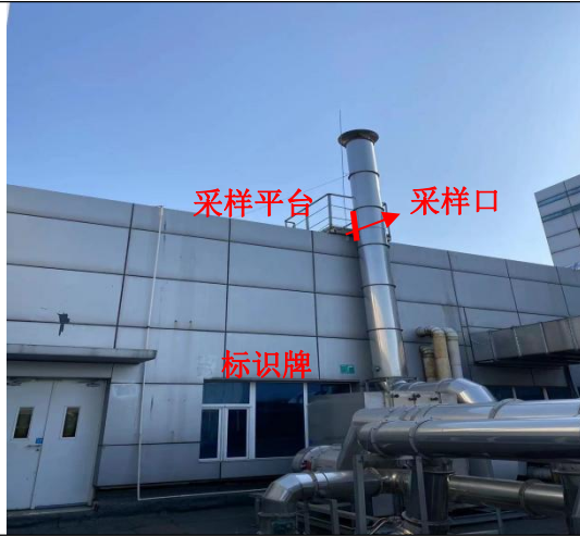
DA003 排气筒规范化
